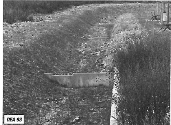
Noue équipée de seuils
