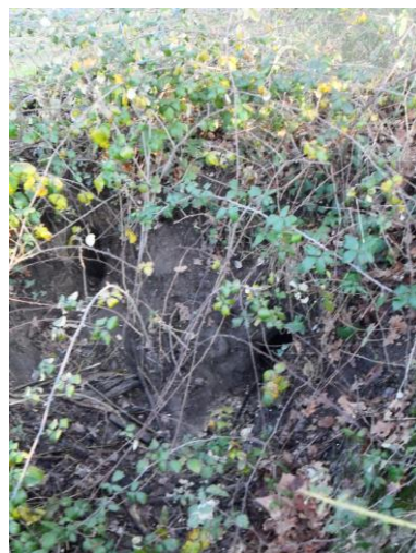
Buse côté amont
