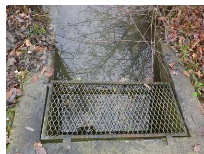
Evacuation Ø200 avec dégrillage
