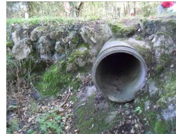
Buse « trop plein »
