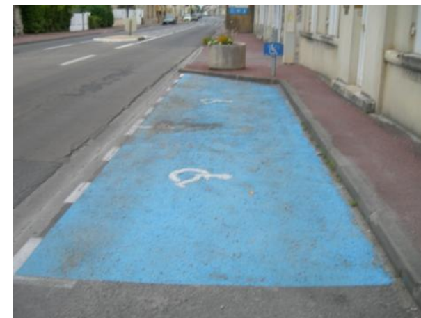
Photo 42: Place pour handicapés avec défaut de signalisation, de marquage et de géométrie (Route de Paris)
