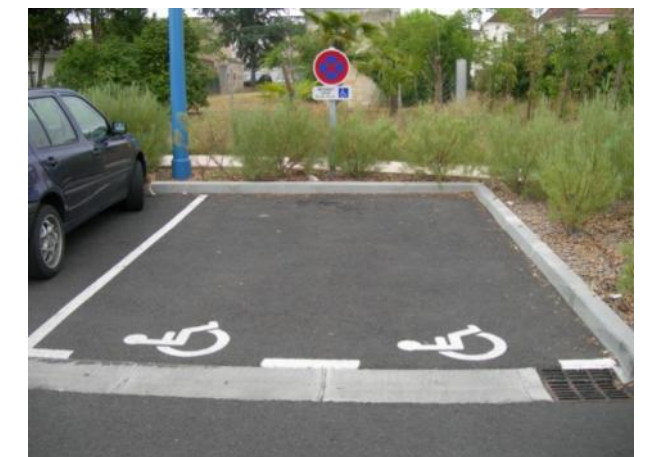
Photo 43: Places aux normes géométriques et signalisation horizontale mais anormale pour le panneau (Rue G. Sand)
